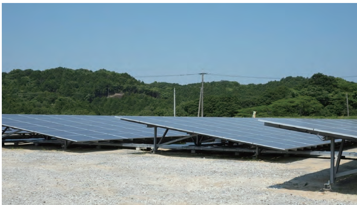
太陽光発電所
